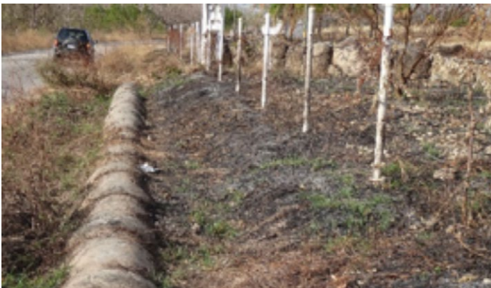
Tubo de concreto luego de un incendio. Fuente ICCYC.
