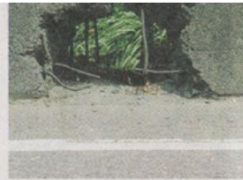
El puente de 32 años y por el que pasan 90.000 vehículos a diario, evidencia las cicatrices del abandono: juntas de expansión tapadas por los remiendos con asfalto, alcantarillas tapadas, barreras destruidas y la losa agrietada. MARYELA LÓPEZ
