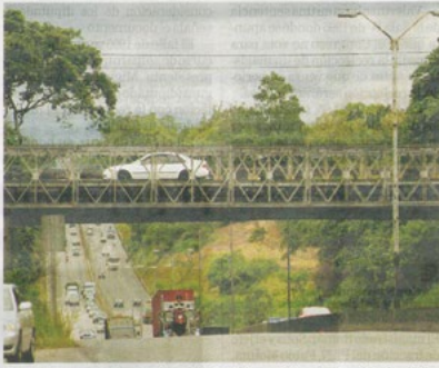
El puente que está frente al colegio Castilla, en Ujiles de Heredia, fue insisto en enero de 2011 para mejorar el flujo de vehículos. ALBERT MORA
