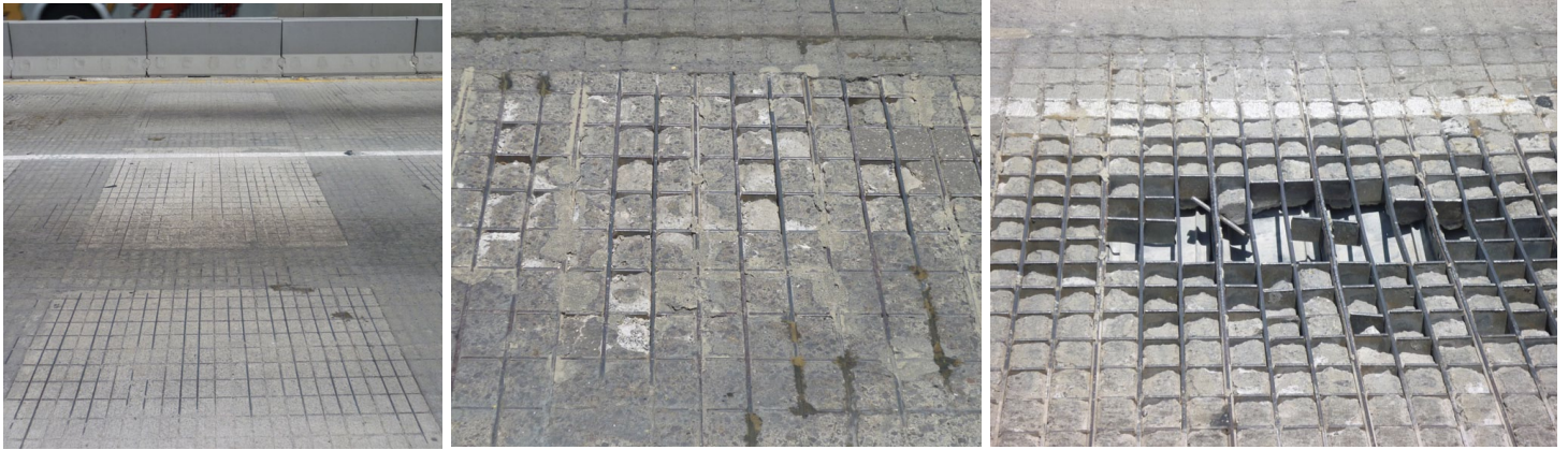
El sistema de rejillas empezó a mostrar un deterioro anormal aproximadamente a los 10 días de entrar en funcionamiento.
