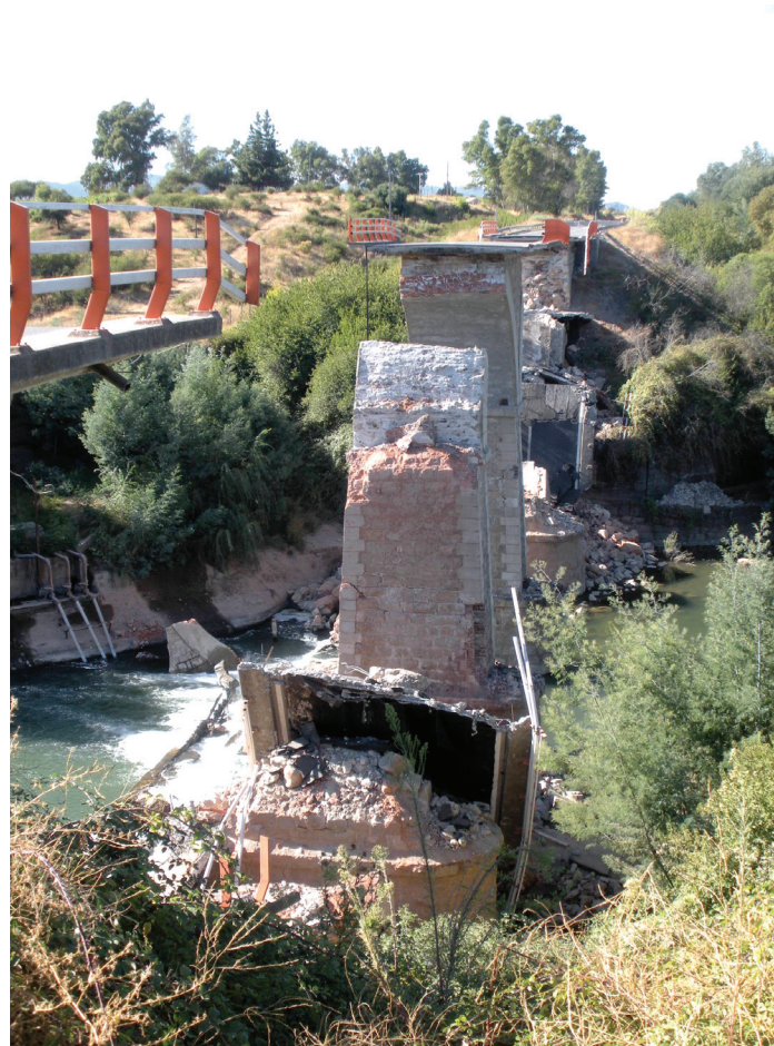
Puente colapsado de mampostería sin refuerzo
