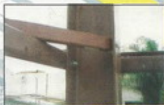
Detalle de conexión en el sistema
