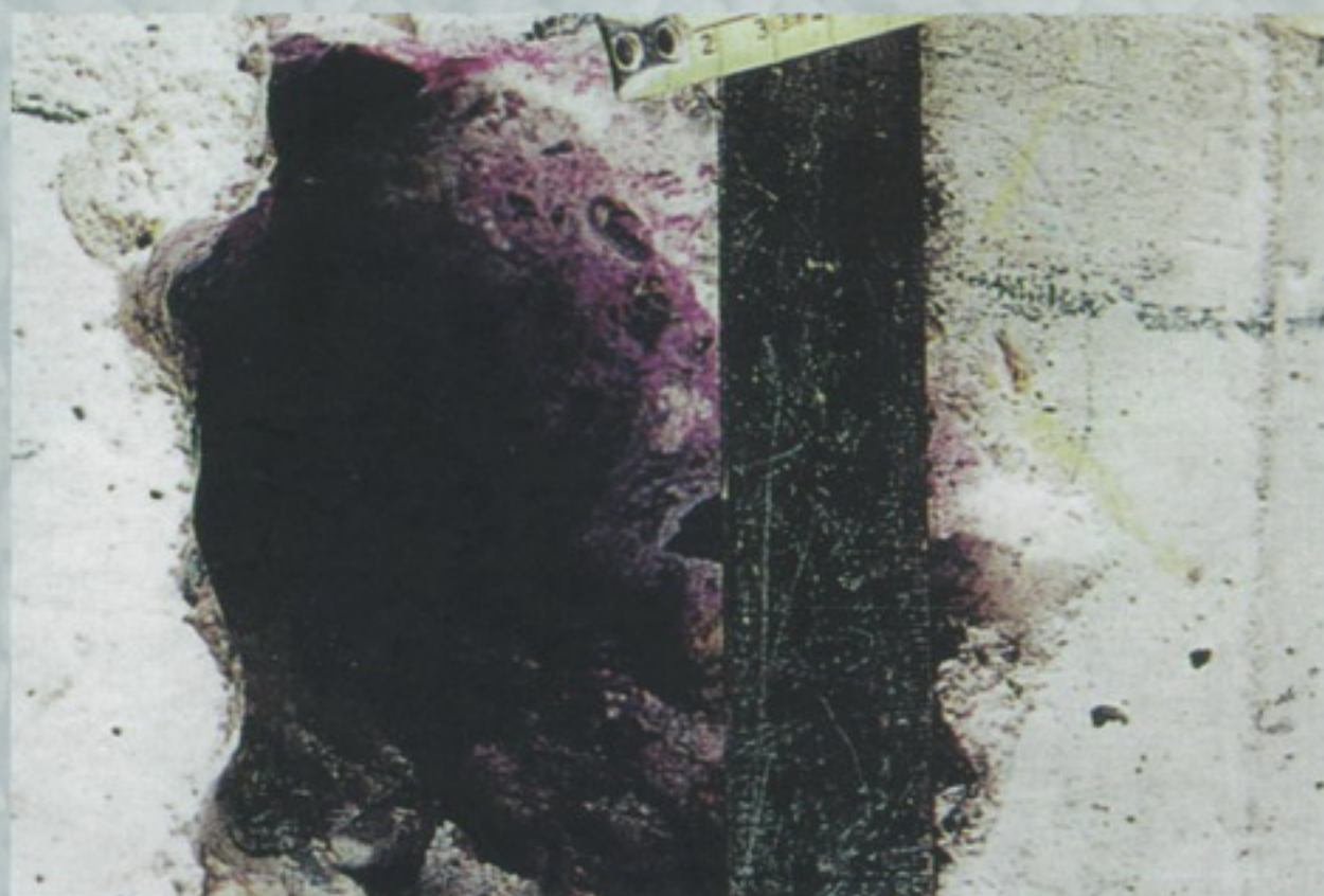
Foto 1. Profundidad de carbonatación del concreto.
