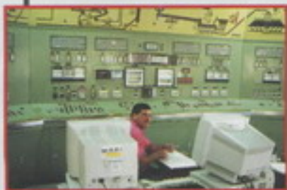
SALA DE CONTROL Desde aquí se controla el proceso de producción.
