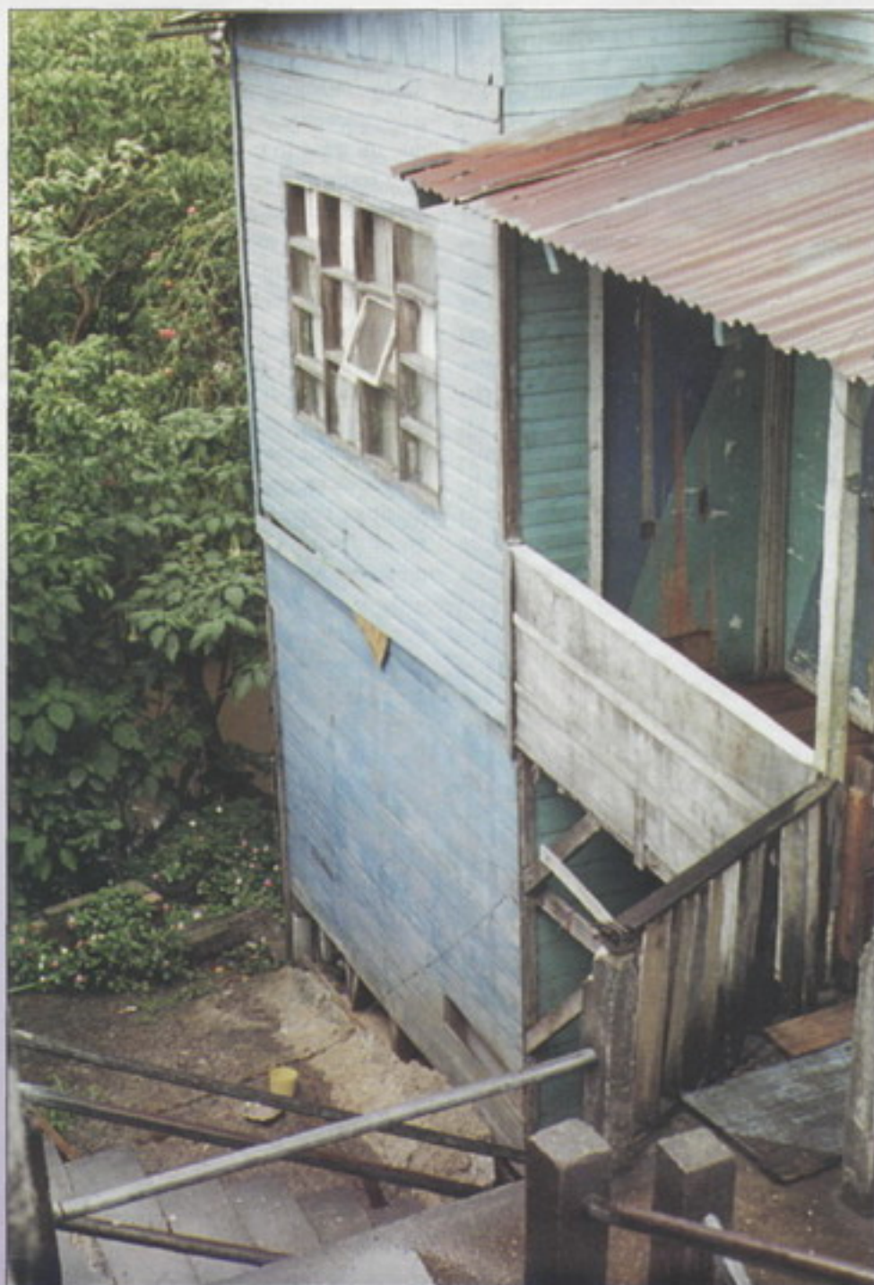
La superpoblación en San José genera viviendas sin las mínimas condiciones de habitabilidad.
