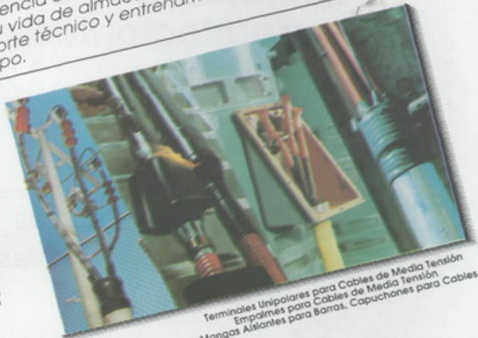
Conexión de Cables para Alimentación de Motores
