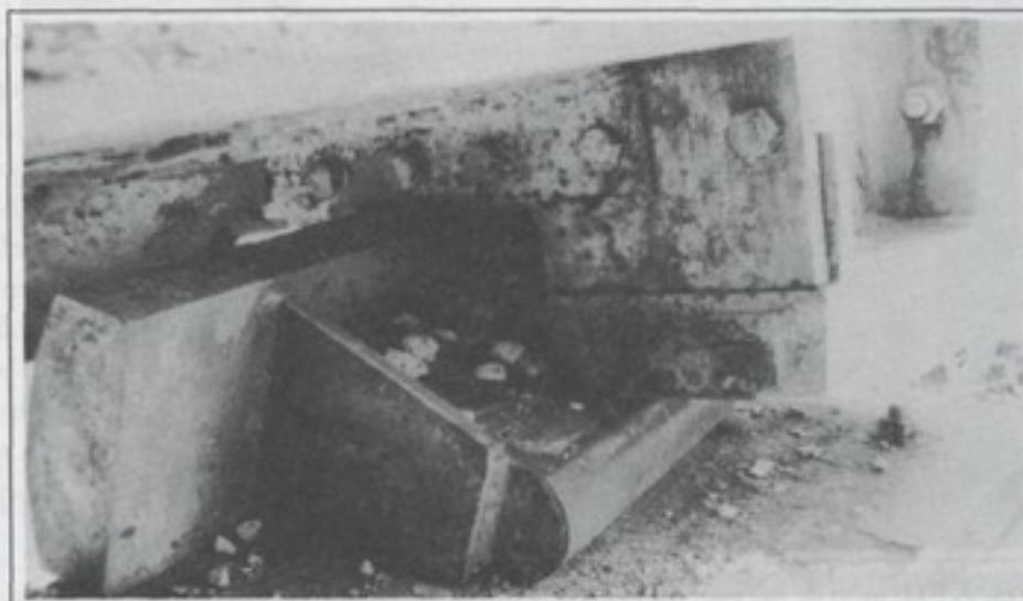
Fig. 5. Puente sobre río Estrella. Los dispositivos de apoyo tipo pendular fueron desplazados y volcados durante el terremoto de Limón en abril 1991, causando la pérdida de soporte y el colapso de los tramos principales.
