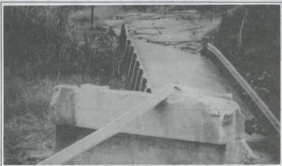
Fig. 1. Colapso de dos tramos del puente sobre el río Bananito, una estructura oblicua con un ángulo de esviaje del eje de la calzada de 25°. Dos tramos de 25 y 28 m., simplemente apoyados, fueron desplazados, perdieron soporte y sufrieron colapso. Terremoto de Limón, 22 de abril 1991.
