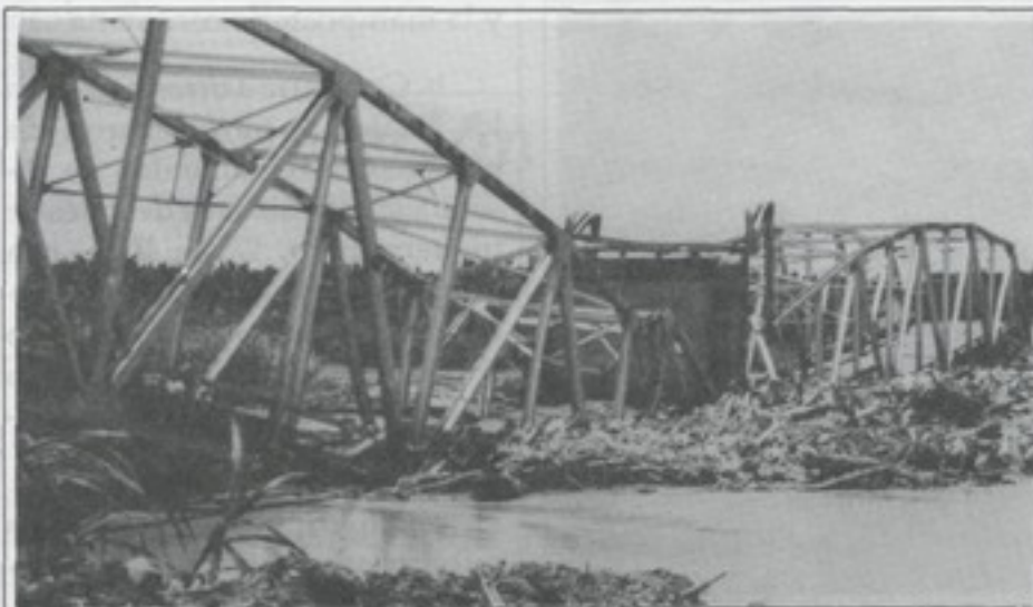
Fig. 4. Puente sobre el río Estrella. Los dos tramos principales, vigas de acero en celosía de 75 m. de luz, sufrieron colapso debido a la falla de los mecanismos de apoyo, que resultaron incapaces de resistir las sollicitaciones sísmicas. La ausencia de dispositivos para restringir los desplazamientos horizontales contribuyó al colapso espectacular de esta importante obra. Terremoto de Limón, 22 de abril 1991.
