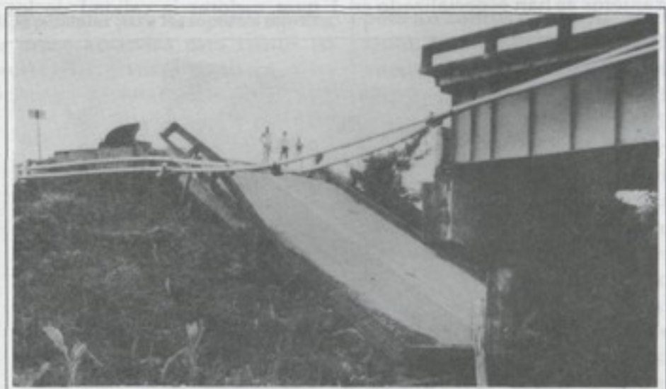
Fig. 3. El tramo de acceso, margen este del puente sobre el río Chirripó, sufrió colapso debido al terremoto de Costa Rica, 1991. Dimensiones precarias de soporte sobre un muro pantalla en la primera pila fue la causa principal del colapso.
