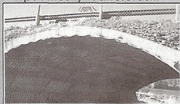
Tuberías abovedadas de acero corrugado...
