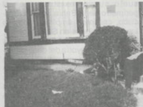
Fig. 6 - Daño típico en una casa de madera en Watsonville. El anclaje de la casa a la fundación estaba hecho por medio de una pared baja de aproximadamente 60 cms. de altura con refuerzo lateral insuficiente. Como resultado, la casa se desplazó cerca de 60 cms. tanto vertical como lateralmente.
