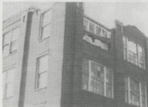
Fig. 14 - Edificio en Oakland mostrando la falla típica de la mampostería reforzada. El colapso de los parapetos ocasionó el colapso del techo. Nótese la gran magnitud de las grietas en las paredes y el daño no estructural.
