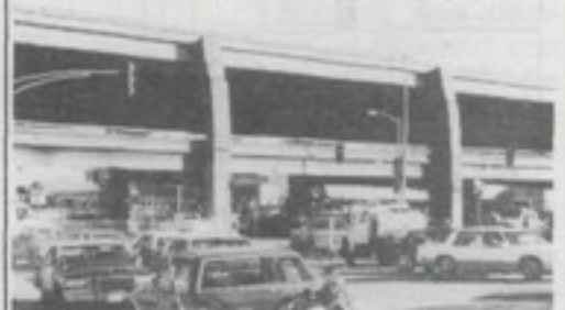
Fig. 20 - Zona del Paso Cypress en donde únicamente colapsó una columna (posterior) por cada marco del segundo nivel. Las columnas del segundo nivel que no colapsaron (al frente) muestran superficies lisas y comportamiento tipo gozne en sus nudos inferior y superior. Puede notarse que estas columnas estuvieron a punto de colapsar.
