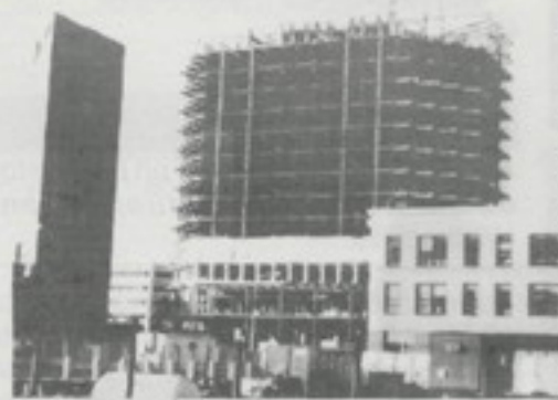
Fig. 16 - Edificio en construcción, junto al Hyatt de Oakland. Ciertos elementos del piso superior fallaron debido a que sus conexiones aún no habían sido completadas.
