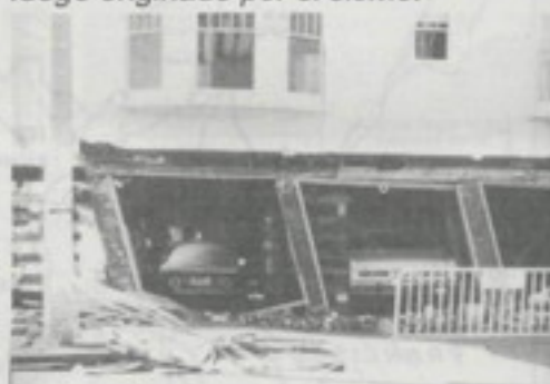
Fig. 10 - Edificio con comportamiento de piso suave en La Marina, San Francisco. Las vigas de acero apoyadas en los elementos de madera, elementos colocados provisionalmente, ayudan a soportar el edificio.
