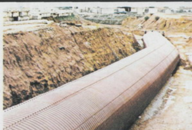
Para Colectores Pluviales
