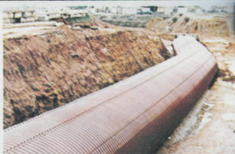
Para Colectores Pluviales
