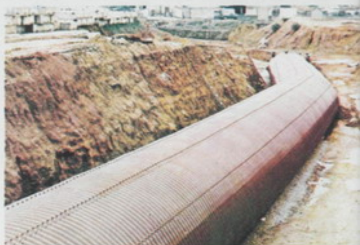
Para Colectores Pluviales
