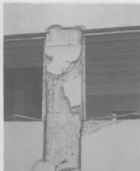
Figura 5 Falla por cortante en columna corta
