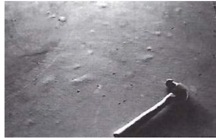
Fotografía N.º 15. Ampollas en el concreto
