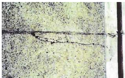
Fotografía N.º 10. Fisura en la junta
