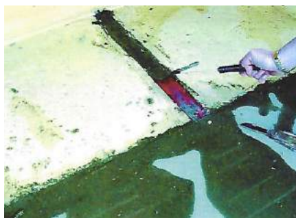
Fotografía N.º11. Falla del sello en la junta
