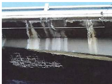
Fotografía N°9. Manchas de eflorescencia
