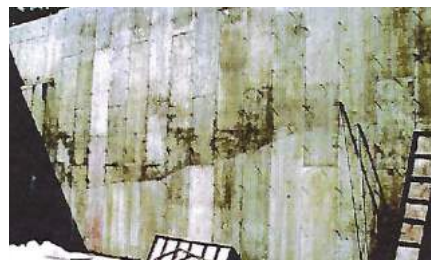
Fotografía N.º 17. Líneas de juntas frías
