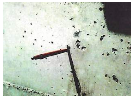
Fotografía N.º16. Burbujas en el concreto
