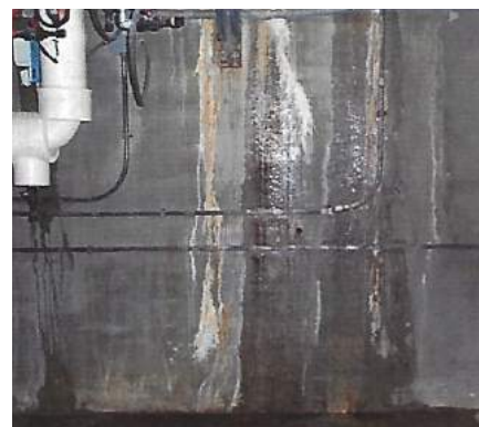
Fotografía N.º12. Líquido migrando a través del concreto
