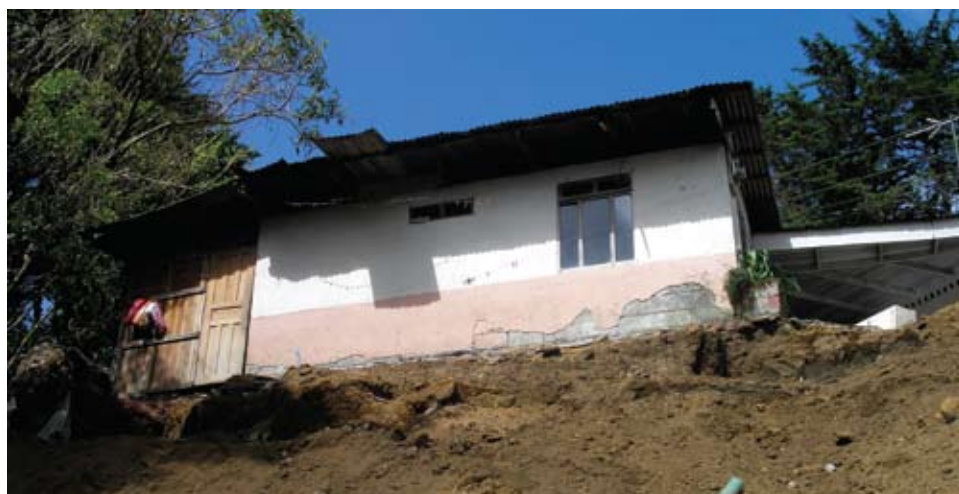
Vivienda al borde de un talud inestable.
