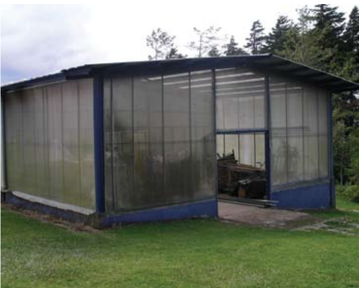
Marco de acero laminado en frío cerca de Fraijanes sin ningún daño.
