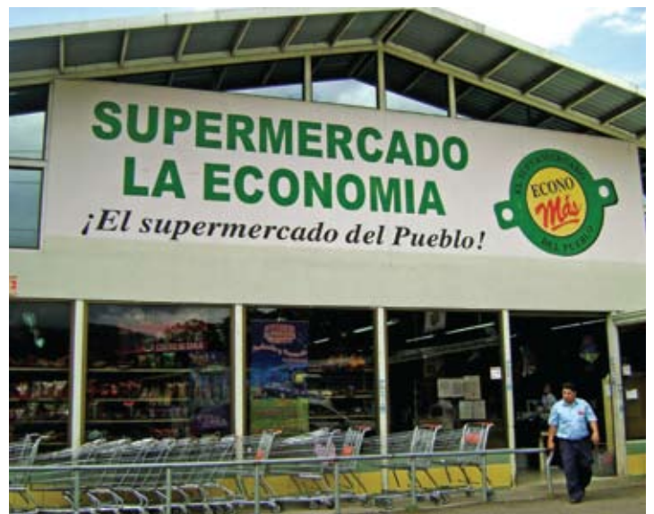
Estructura de acero en buen estado. Nótese la integridad de las ventanas y sus cristales.
