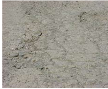
Grietas por fatiga
