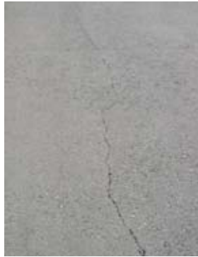
Fisura por retracción
