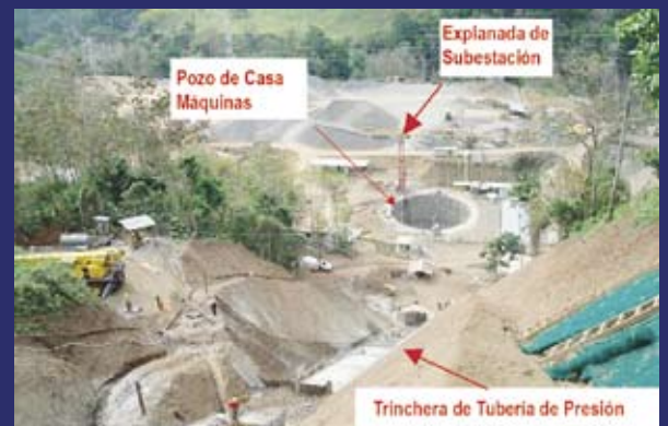
Vista panorámica de sitio de Casa de Máquinas del P.H. Pirrís
