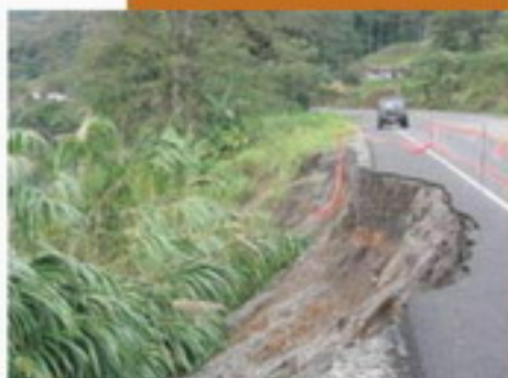
Destrucción del borde derecho de la calzada debido al deslizamiento que sufrió el talud.
