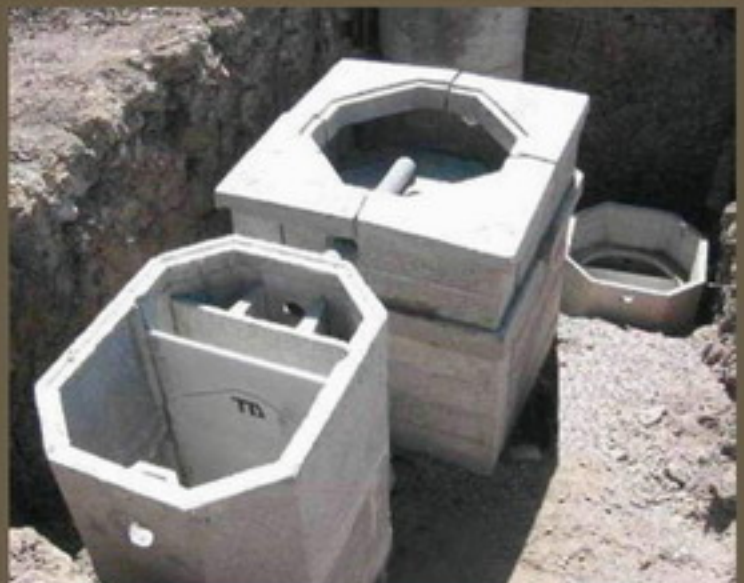
Detalle de unidades de depuración
