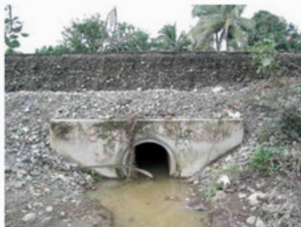
Alcantarillas que en caso de inundación no tienen la capacidad para captar el flujo que viene de los canales, provocando serios daños en la estructura de la carretera.
