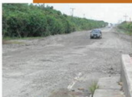
Destrucción total de una sección de la vía, la superficie de rodamiento colapsó completamente debido al paso del agua.
