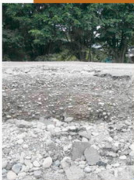
Exposición de la estructura de la carretera; se observa sedimento y acumulación de agua, producto de las inundaciones.
