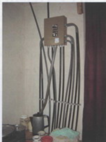
Instalaciones eléctricas inadecuadas.
