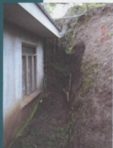
Riesgos por deslizamientos.
