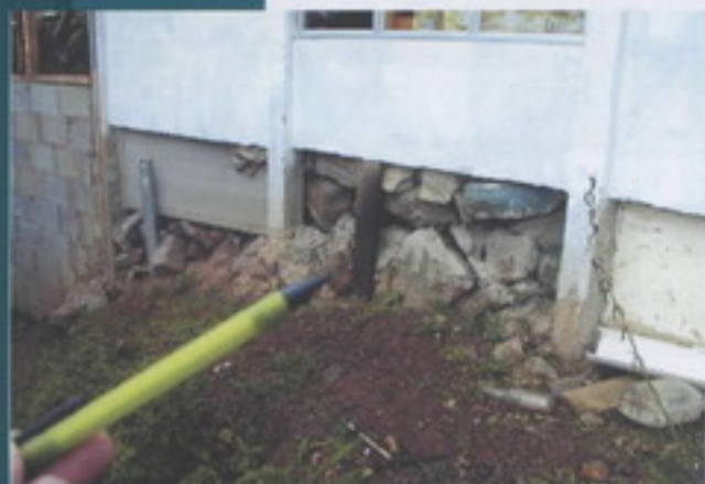
Utilización inadecuada de baldosas.
