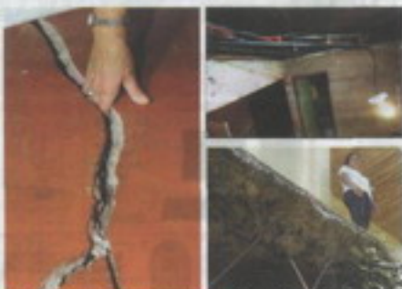
Se ven en las fotos, torceduras evidentes en la calidad y torcidos baldosas y cañerías con los patillos que provocan problemas en la cuarta auditoría sobre la calidad de las viviendas de interés social.
