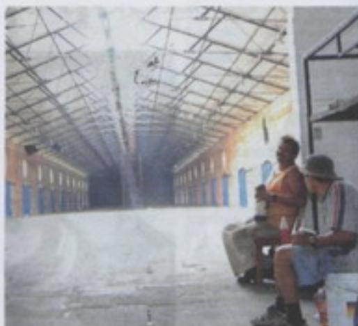
Los trabajadores Óscar Retana y Heber González participaron en las reparaciones del techo de la antigua Aduana en el 2005. ARCHIVO
