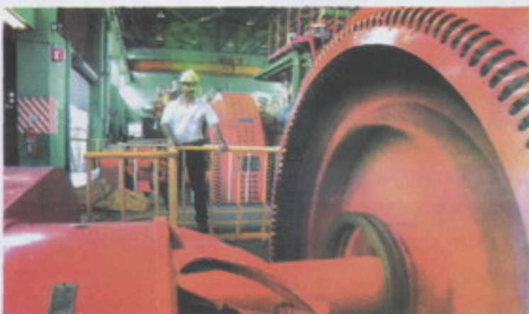
El Colegio de Ingenieros y de Arquitectos consideró que las entidades estatales no solo deben invertir en construcción de plantas para generación eléctrica (como esta térmica que funciona en Tibás), sino que también se debe dar más oportunidad a los entes privados.
