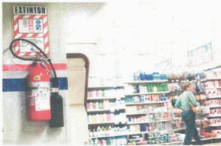
La colocación de extintores es parte de exigencias que emitió el Cuerpo de Bomberos (foto ilustrativa). -NACION
