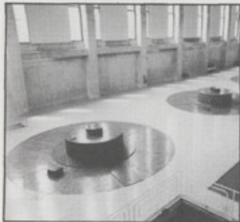
Unidades turbogeneradoras de la planta hidroeléctrica Corobicí
