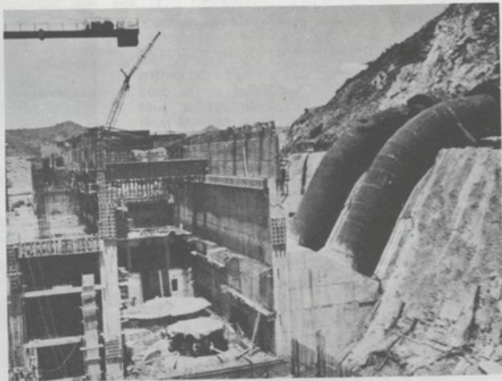
Tuberías de presión acopladas a los túneles en la Presa de Carrón Grande.
