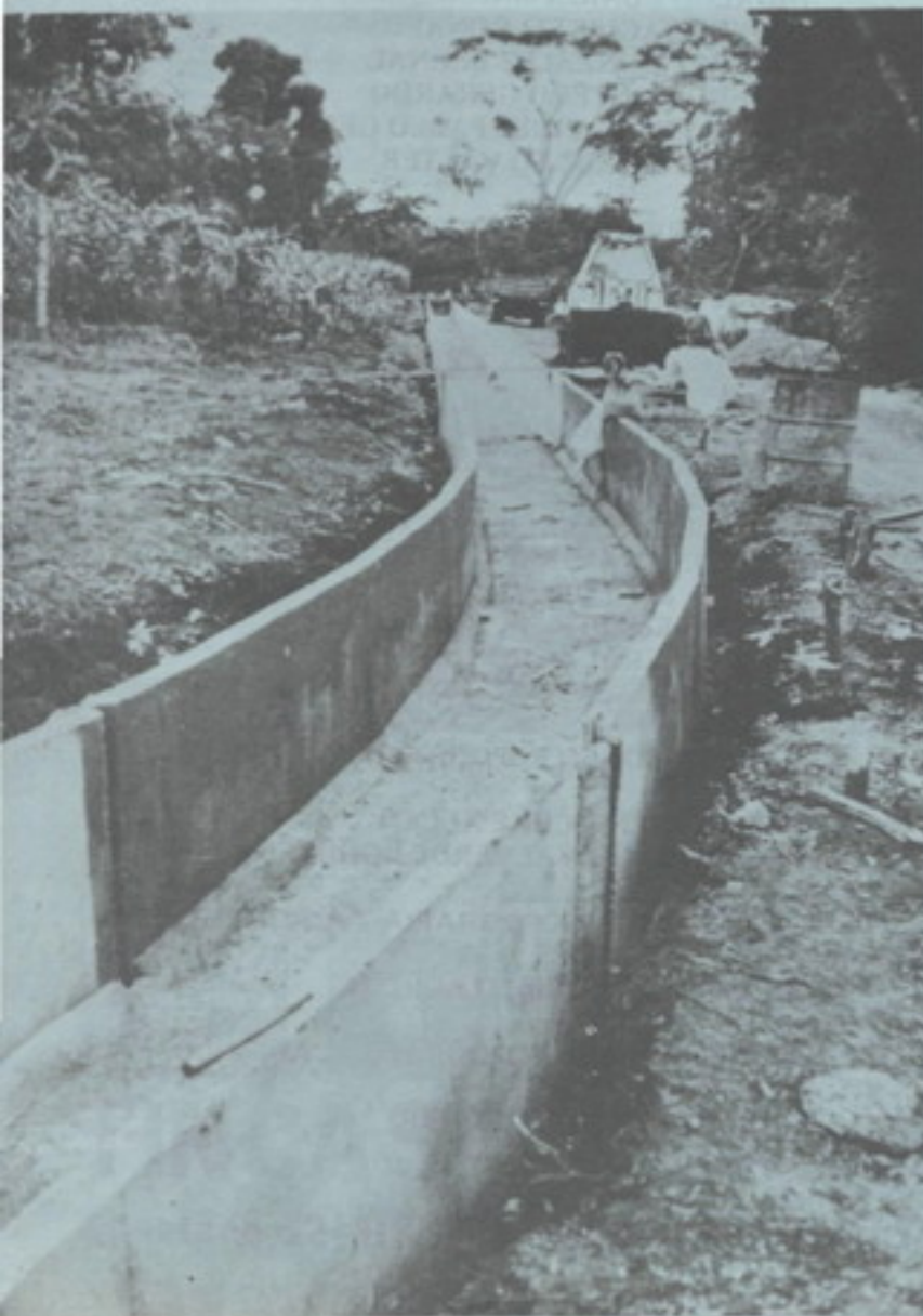
Canaleta para conducir al mar las aguas residuales de la planta.
