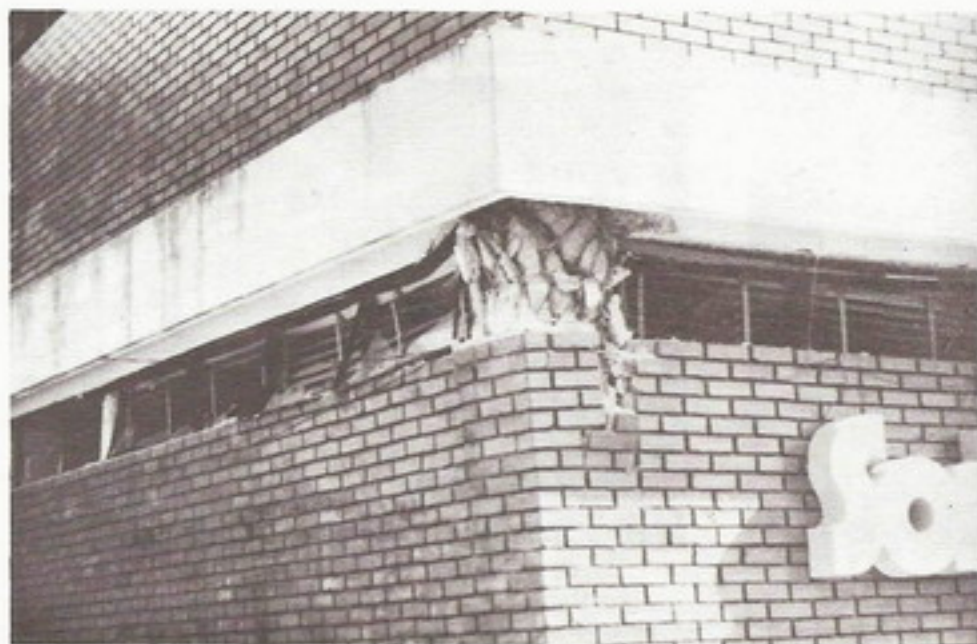
El efecto de columna corta producido por elementos de mampostería que restringen los desplazamientos convirtiéndolos en elementos cortos y rígidos, que atraen mayores fuerzas laterales y reducen su capacidad de absorber energía por deformación plástica, es causa de la falla y en muchos casos del colapso de la estructura.
