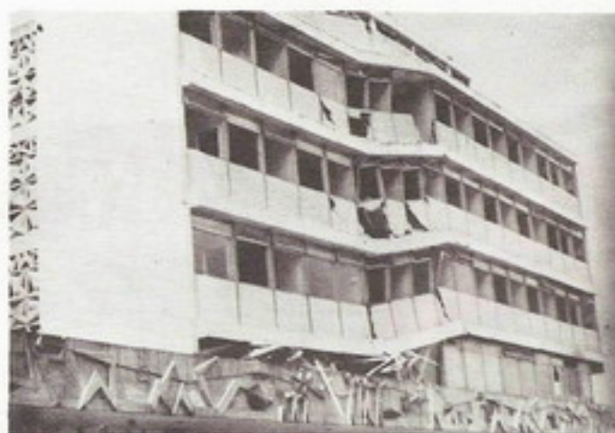
Algunas obras de construcción reciente sufrieron colapso. Observamos en la figura el Hotel Terminal.
