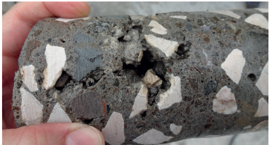
Imagen 1. Núcleo que evidencia deficiencias de compactación del concreto.
