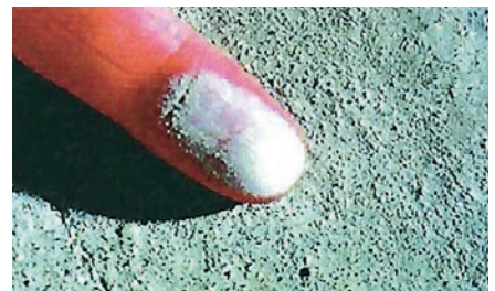
Fotografía N.º 8. Desprendimiento de polvo
