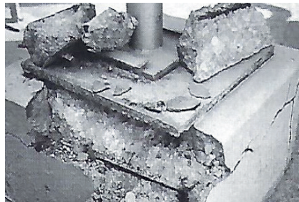
Fotografía N.º5. Deformación y desprendimiento debido a la corrosión del refuerzo
